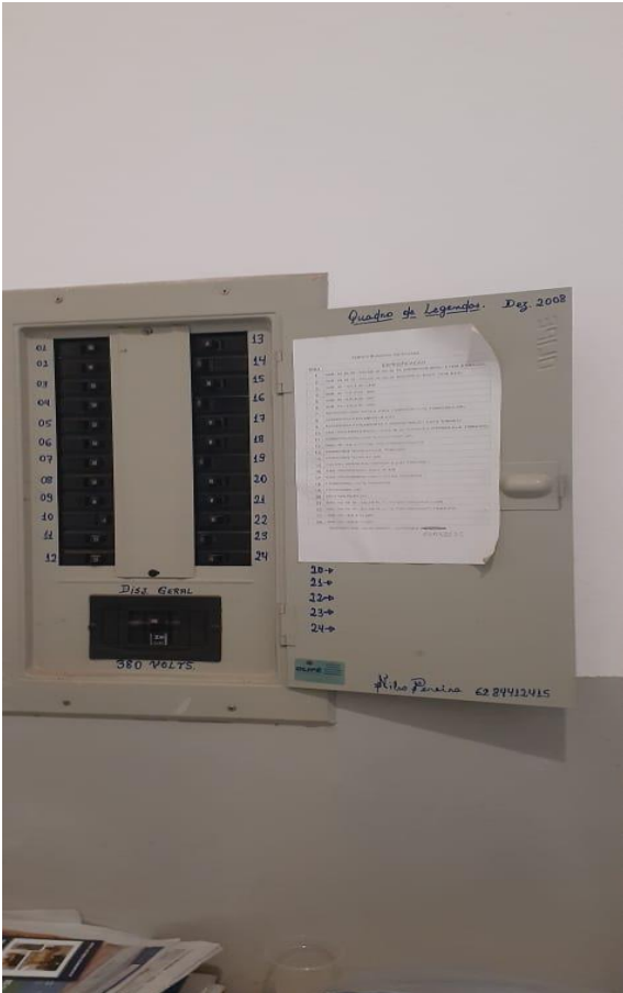
Foto 18 – Imagem do quadro de distribuição geral.
