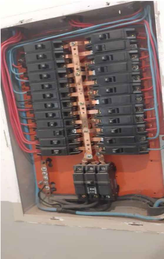
Foto 20 – Imagem do quadro de distribuição geral.
