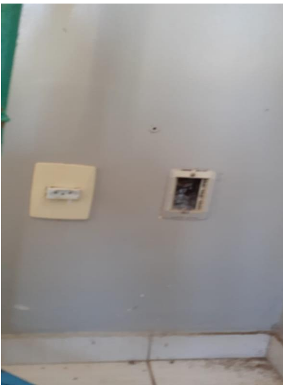
Foto 21 – Imagem das instalações elétricas.
